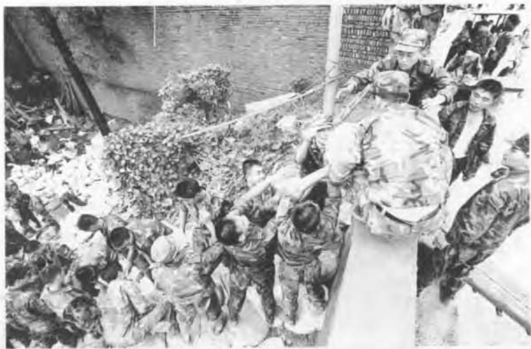
1998年7月30日，丹水池中南石化堤段发生管涌， 全体军民奋力抢险，终使堤段化险为夷
